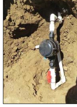
Foto 2: Instalación inadecuada del medidor y tubos con codos
