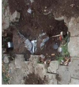
Foto: Robo de agua (Conexión ilegal de con tubería de By-Pass)
