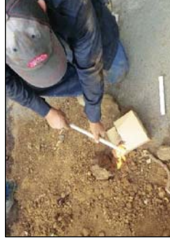
Foto 1: Conexión inadecuada con el calentamiento del tubo PVC a fuego directo
