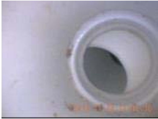
Imagen de la válvula de tubería de conexión domiciliar
