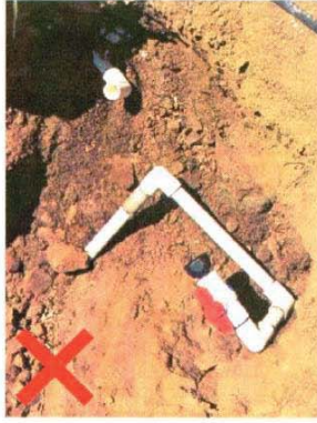
Figura N° 35. Alineación de tubo de conexión domiciliaria con una cantidad innecesaria de codos.
