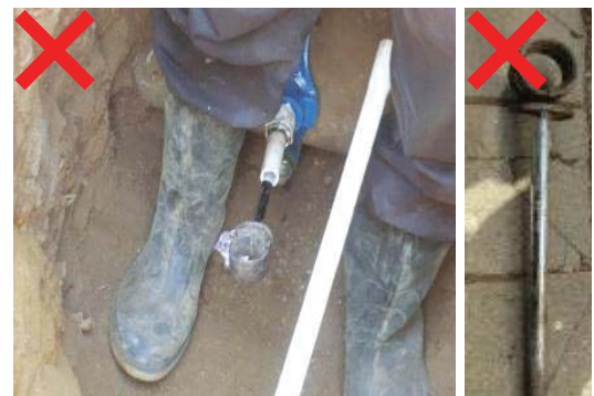
Figura N° 30. Imágenes de perforaciones con herramientas inadecuadas.
