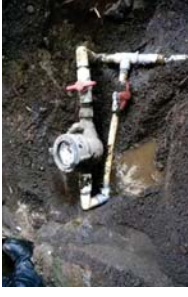
Conexión ilegal detectada en el MIS No.61
