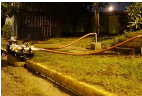
P-27 MS61 サブセクター3の漏水量直接測定
