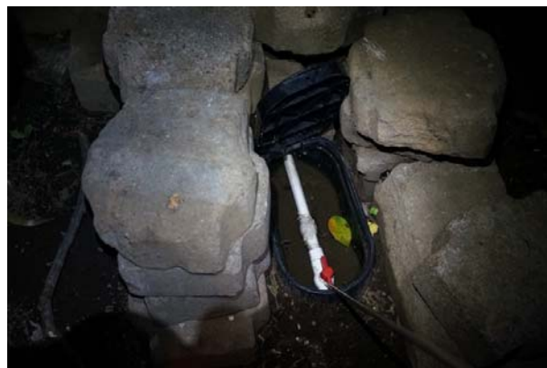
P-28 MS61 サブセクター2の漏水探知
