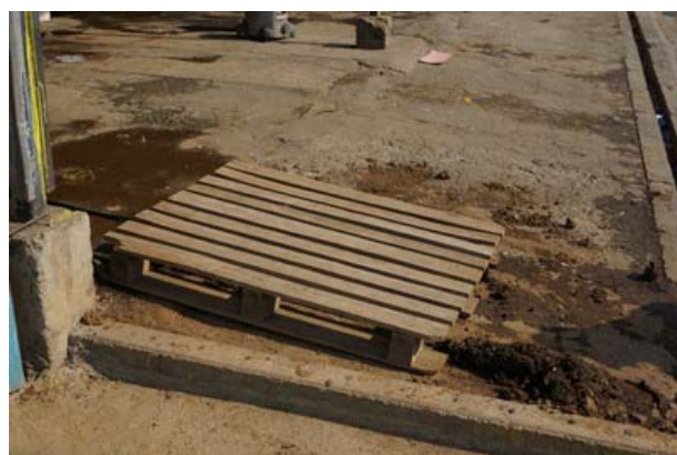
P-29 違法接続の例
