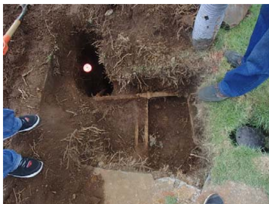
P-37 複雑な給水管の配置
