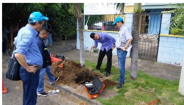
P-41 漏水発生管路の探知
