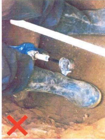
Figura N° 30. Imágenes de perforaciones con herramientas inadecuadas.
