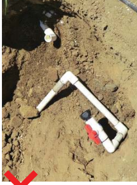
図 35 無駄に曲管の多い給水管アライメント
