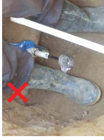
図 2 不適切な工具による穿孔状況
