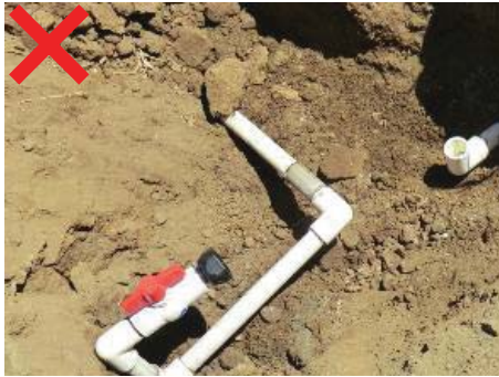
Figura N° 35. Alineación de tubo de conexión domiciliaria con una cantidad innecesaria de codos.
