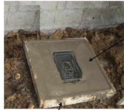
Figura N° 37. Ubicación de medidor.
