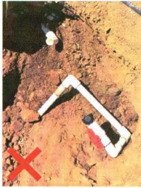
Figura N° 35. Alineación de tubo de conexión domiciliaria con una cantidad innecesaria de codos.
