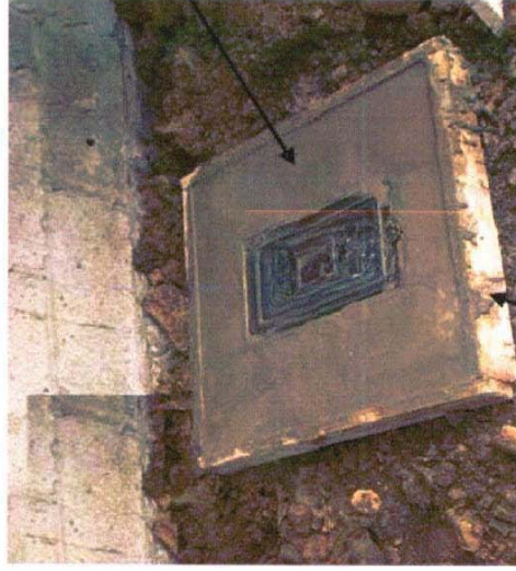
Figura N° 37. Ubicación de medidor.
