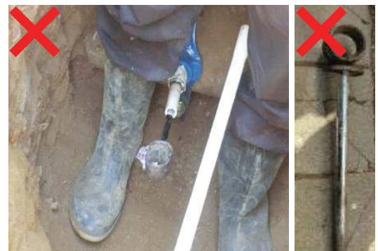
Figura N° 30. Imágenes de perforaciones con herramientas inadecuadas.
