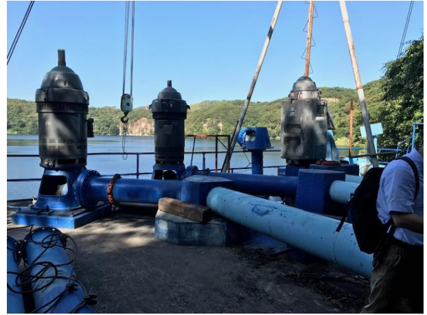
現場視察 アソソスカ湖 取水ポンプ (12月18日)
