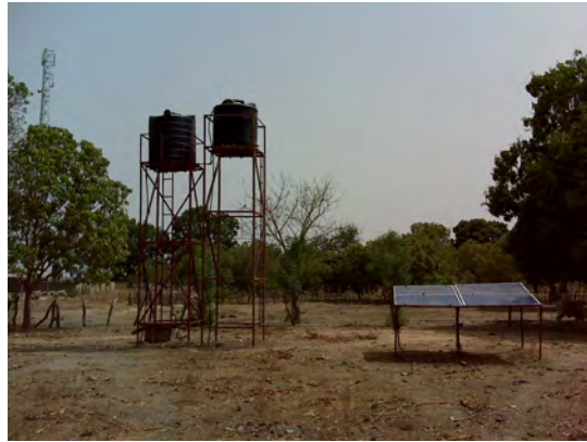
既存ソーラー揚水システム (N-13 Kolor Complex)
