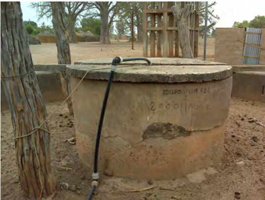
既存管路給水施設の水源 (N-21 Ngaige Complex)
