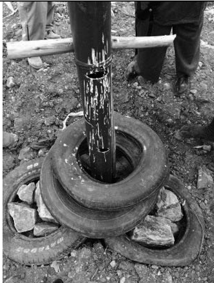
ガス抜き管@Koshes 処分場
