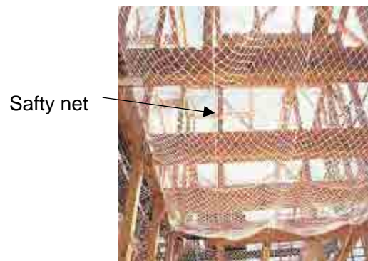
図 12-3-7. 鋼桁下の安全ネット
