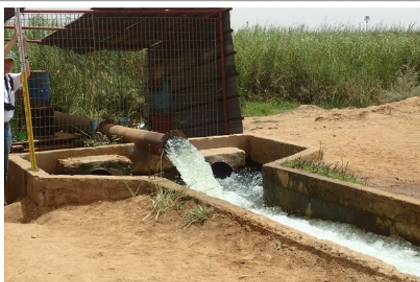
Station de pompage pour l'irrigation dans le périmètre de Rosso Le 11 juin 2019
