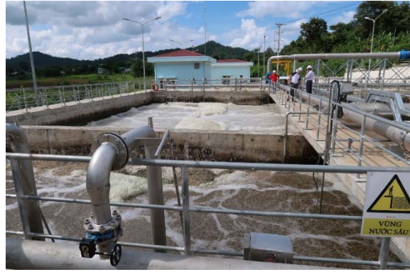
Bể MBBR và bể lắng
