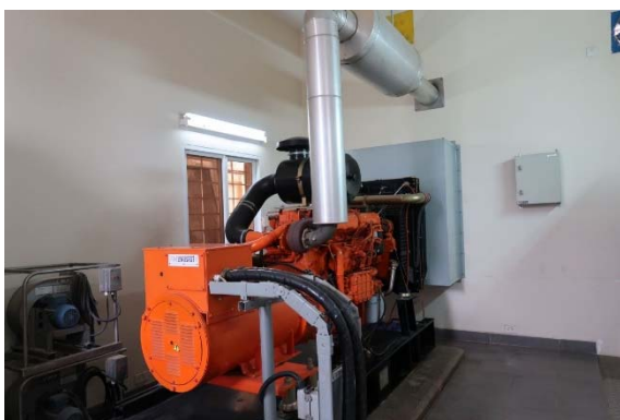
Máy phát điện
