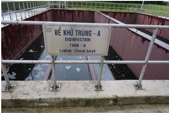
Bể khử trùng
