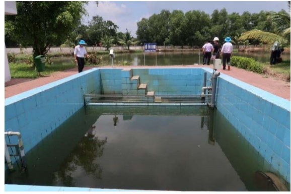
Bể khử trùng
