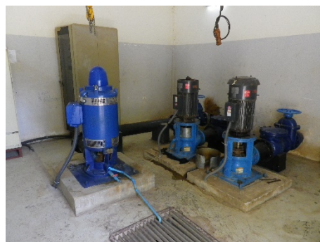
② 既存立軸ポンプ駆動用電動機
