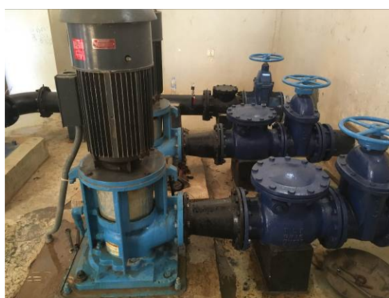
写真 1-3 : 既存取水ポンプ (2017 年 6 月)
