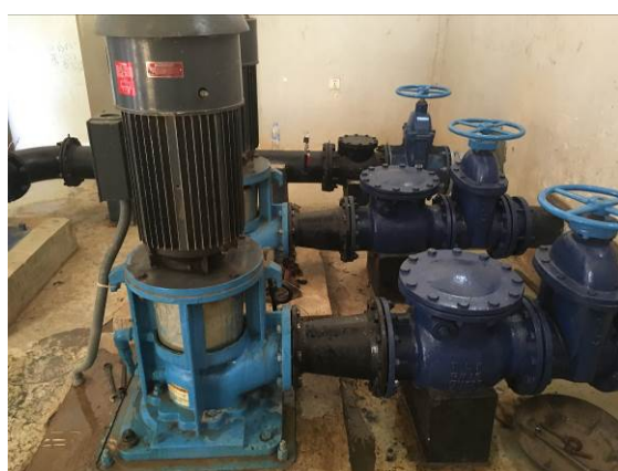
写真 1-3 : 既存取水ポンプ (2017 年 6 月)
