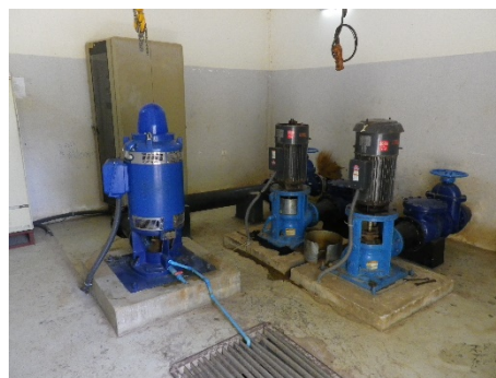
② 既存立軸ポンプ駆動用電動機
