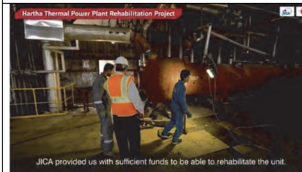
ハルサ発電所改修事業：overview
