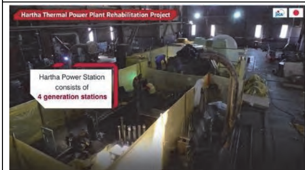
ハルサ発電所改修事業：overview
