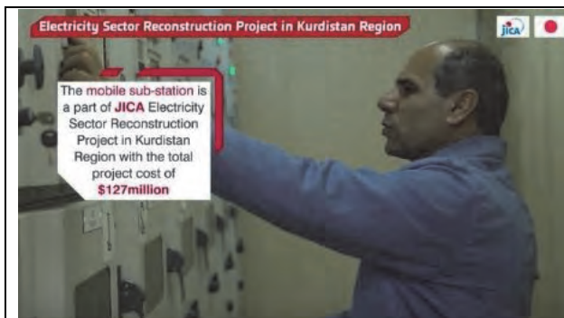
クルド地域電力セクター復興事業：overview Mobile substation
