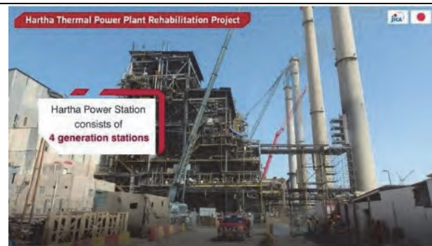
ハルサ発電所改修事業：overview
