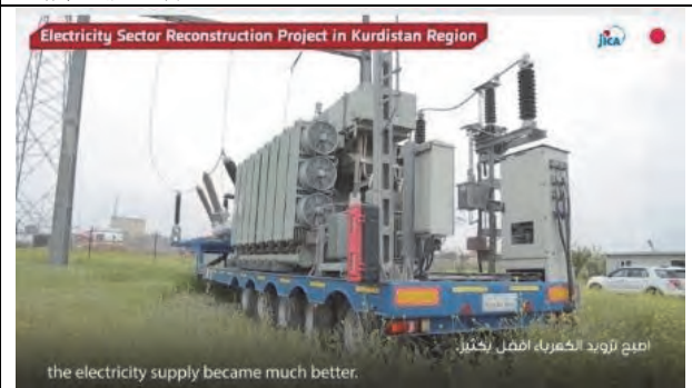
クルド地域電力セクター復興事業：overview Mobile substation
