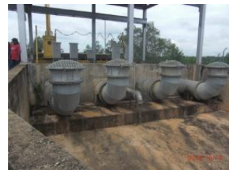
排水ポンプの排気口
