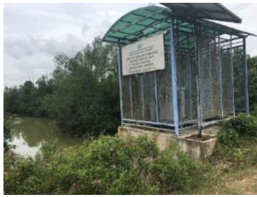
調整池の流出口の小型水門
