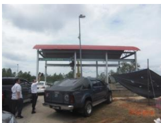
調整池クアンタン川側の排水機場
