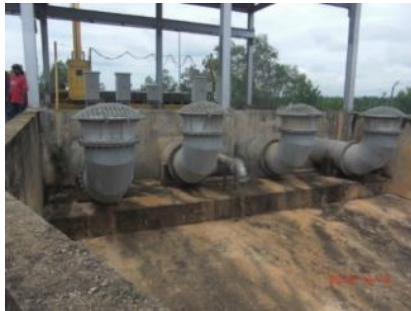
排水ポンプの排気口
