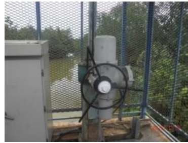
排水機場に隣接する排水ゲート操作機
