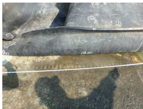
写真-21：本体下部損傷 (2018/7/24)
