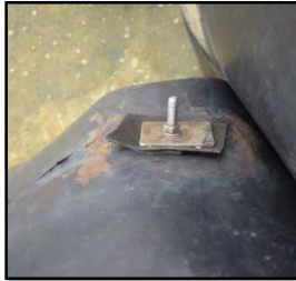
Menyebabkan kerusakan ke lokasi lain di bagian ujung @Rambatan
