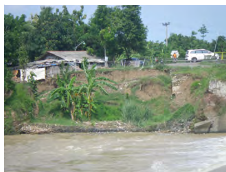
写真-40 : ランバタン#3 護岸崩落
