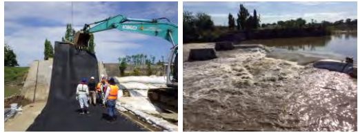
(5) Pemasangan no2 (Pertama) (6) Jebolnya Kisdam
