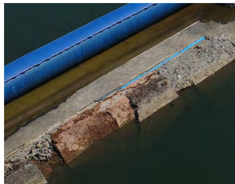
写真-39 : ランバタン#3 エプロン損傷
