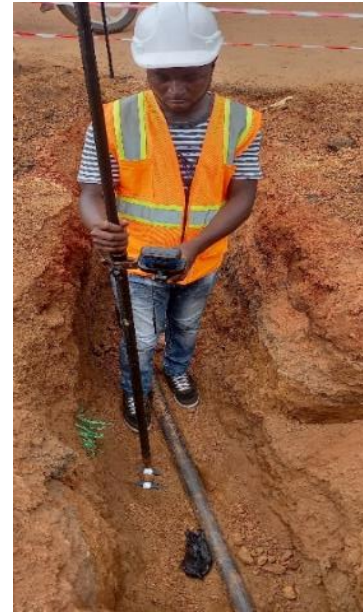
Tuyau PVC 90 mm croisant un câble
