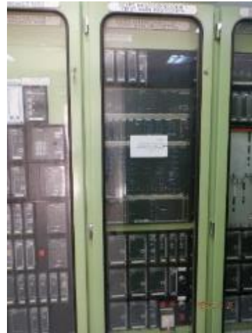
No.08: 400kV アカバ変電所保護リレー盤。旧型 アナログリレーで構成されている。
