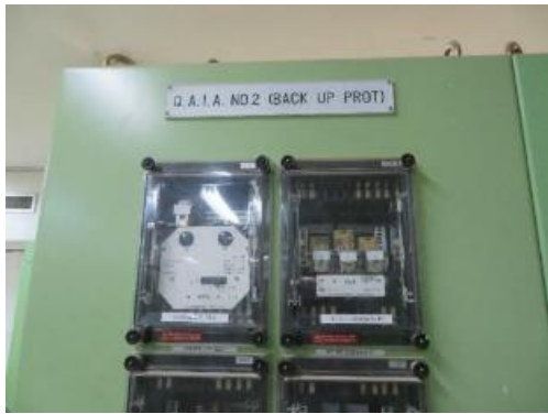
No.05: アンマンサウス 132kV 保護リレー盤 古い電気機械機械型が使用されている。
