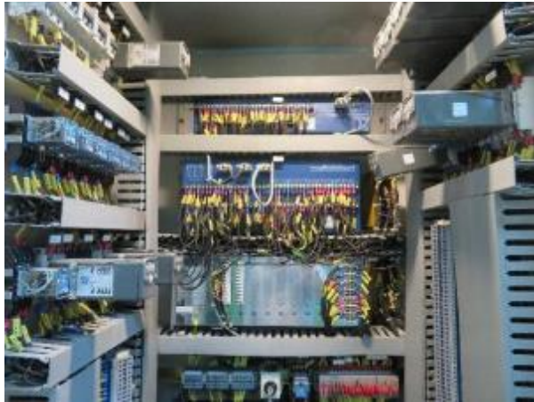
No.13: 400kV アンマンサウス アンマンイースト線 Main2 盤裏面
