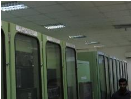
No.07: 400kV アカバ変電所リレー室。盤構造等ア ンマンサウスと同様の扉付き構造。
