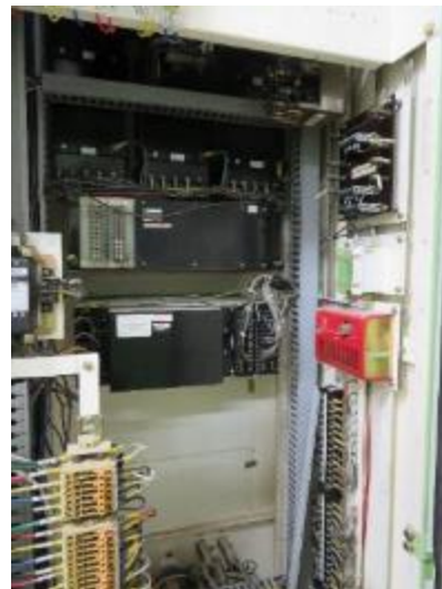
No.16: 132kV アンマンサウス Q.A.I.A線主保護裏面
