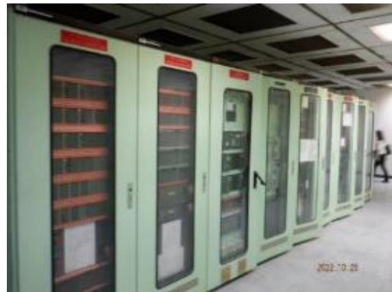
No.10: 132kV アカバ保護リレー盤。発電所制御 室の壁際に設置されているが、新リレー室に設 置のため撤去予定。
