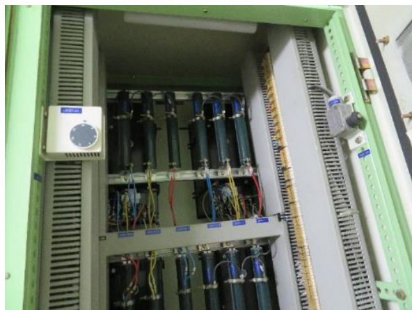
No.15: 132kV アンマンサウス 母線保護裏面
