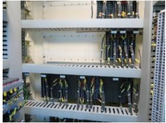
No.12: 400kV アンマンサウス 400/132kV SGTR1 Main1 盤裏面
