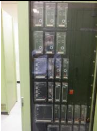
No.09: 400kV アカバ変電所 遮断器制御盤。旧型 アナログリレーで構成されている。
