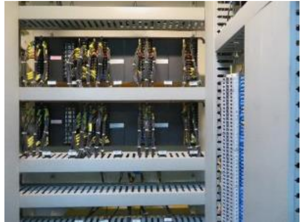
No.14: 400kV アンマンサウス 400kV 母線保護盤裏面
