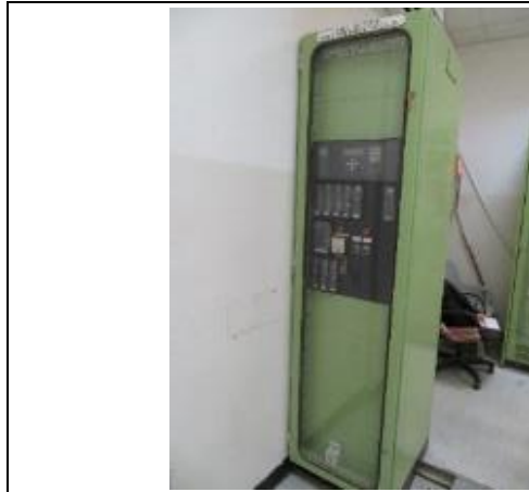
No.11: 400kV アカバケーブル電気所 ケーブル保護盤
