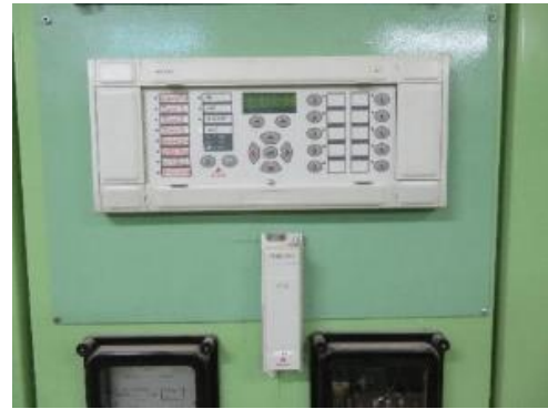
No.06: アンマンサウス 132kV 保護リレー盤、 NEPCO によるユニット交換事例。NEPCO の施 工品質に問題ない。
