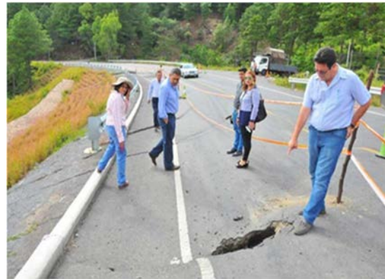
【工事後の変状発生状況】
