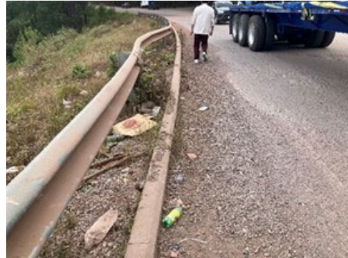
【ガードレールの変形】
