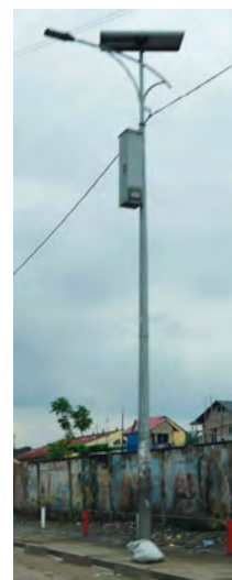
Figure 3-4.2 Éclairage de rue installé (exemple)
