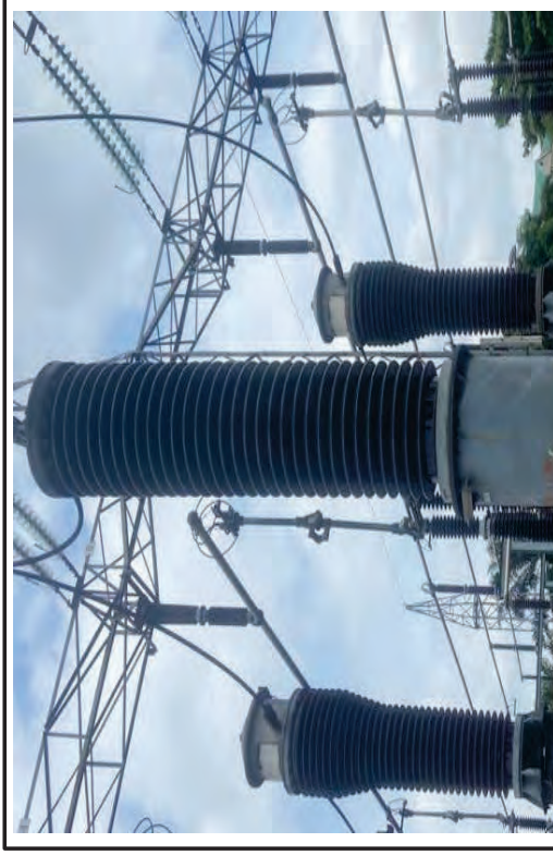
Photo n°07 : Transformateur Potentiel (T.P) de la sous station de la Funa
