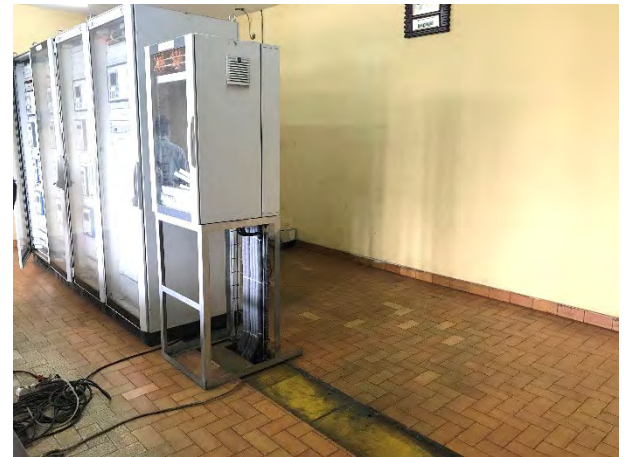
リミंगा変電所 保護制御盤設置予定箇所
