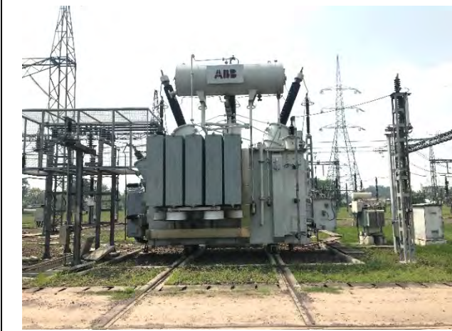
リミंगा変電所 改修予定変圧器
