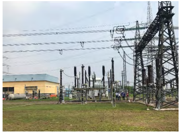
リミंगा変電所 改修予定 220kV 開閉設備
