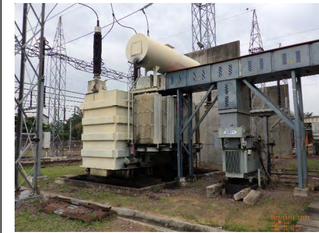
フナ変電所 改修予定変圧器
