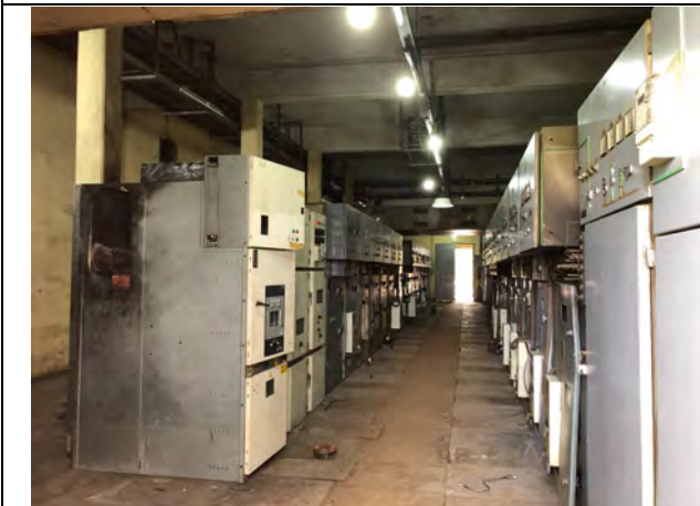
フナ変電所 改修予定 20kV 開閉設備
