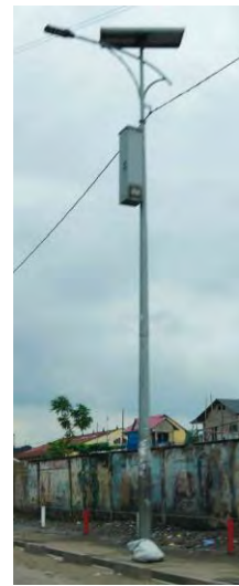
図 4-4.2 道路灯の設置例
