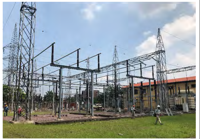
フナ変電所 改修予定 220kV 開閉設備(変圧器 No.2 ペイ)
