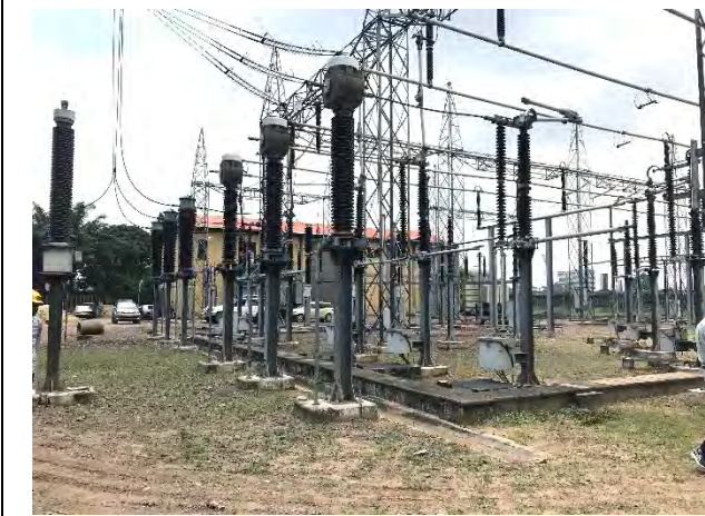
フナ変電所 改修予定 220kV 開閉設備(リミング受電部)
