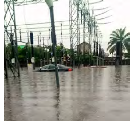
図 2-2.1 フナ変電所の冠水の様子
