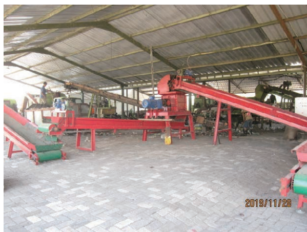
統合廃棄物処理場（シドアルジョ県）
