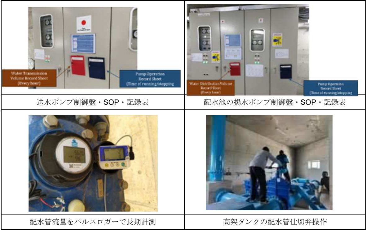
写真 5 送水・配水施設と SOP
