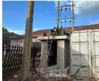
既存施設を発電機から市中電力 に切替えるための受電施設
