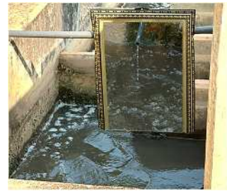
凝集剤注入目視確認用ミラーの 設
