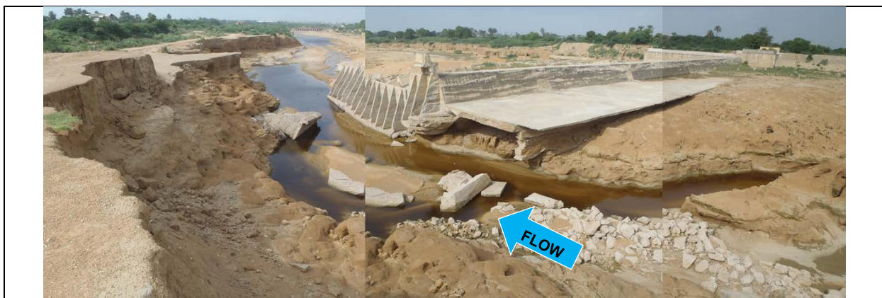
Malir Weir 1 : 左岸のアバット部が破壊されている。砂礫地盤な為、浸食されやすい。
