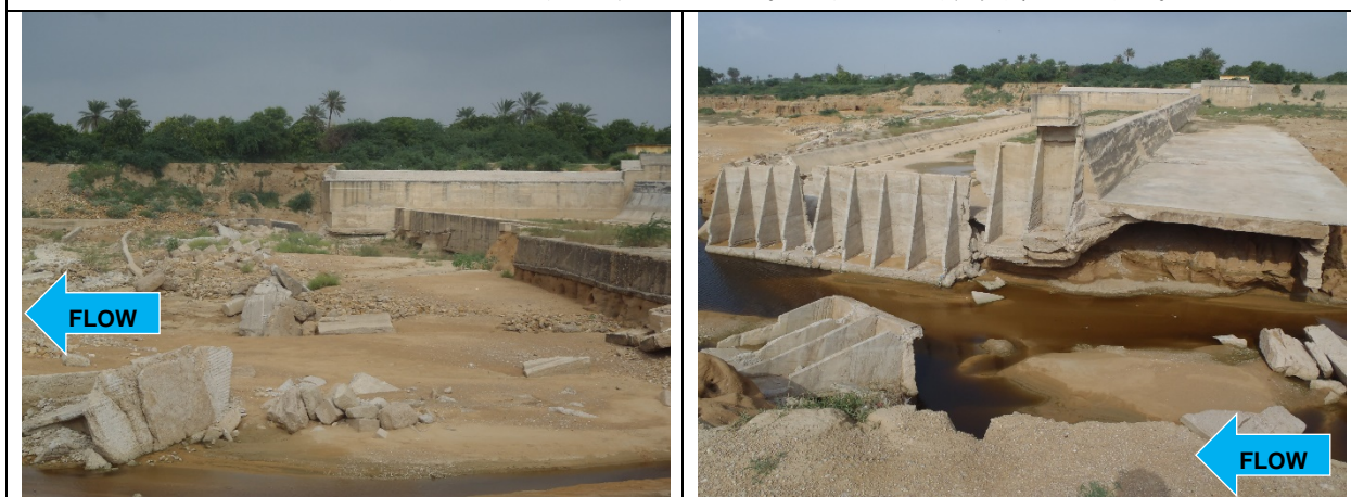
Malir Weir 1 : 堰下流の河床低下により基礎が露出
