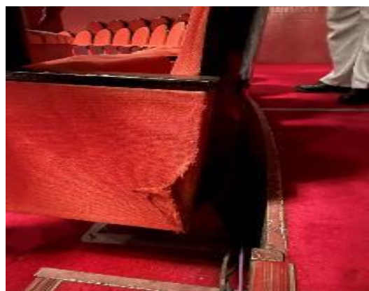
写真-11:大ホール内の座席の側面が一部損傷している既存座席
