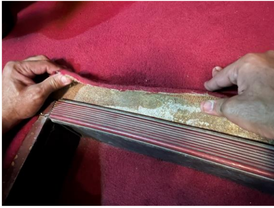
写真-13:老朽化により損傷がみられる階段部分のカーペット
