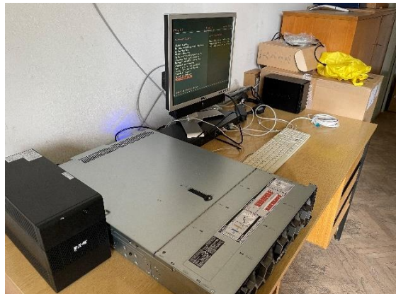
写真-16：既存のサラエゴ大学とのVPNサーバー
