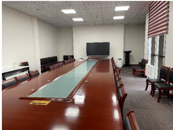
写真-11:4階会議室 ビデオウォールシステムが設置される
