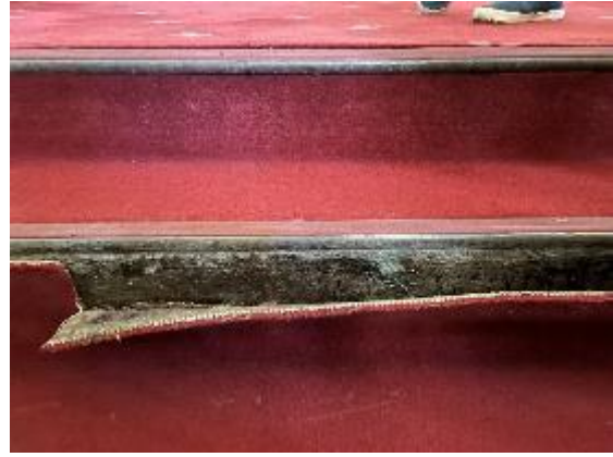
写真-14:老朽化により損傷がみられる階段部分のカーペット
