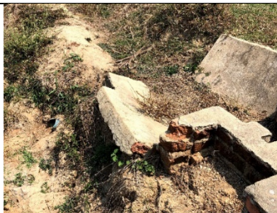
3次水路の破損の状態
