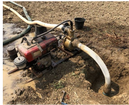
圃場内での地下水くみ上げの様子
