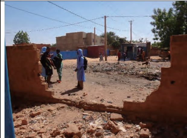
【No.7 CES KOIRA TEGUI】破壊された境界塀。ここから、外部者が校内に侵入したり、生徒が出ていくこともある。
