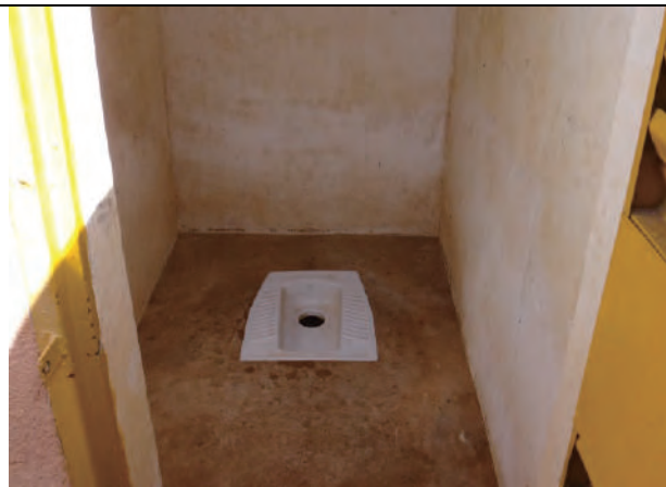
【No.23 CEG Nordiré】先行案件によるトイレ棟内観
