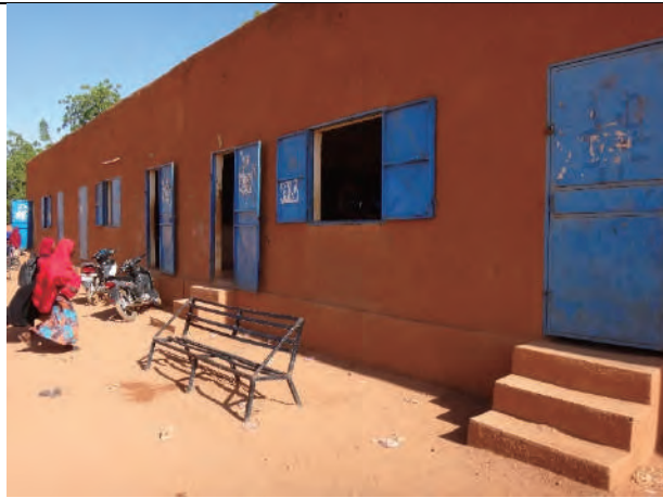
【No.14 CES Aéroport 1/B】現地仕様の教室棟の外観。廊下や庇がない。
