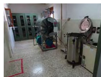
既存の高圧蒸気滅菌器
