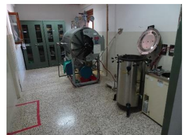
既存の高圧蒸気滅菌器
