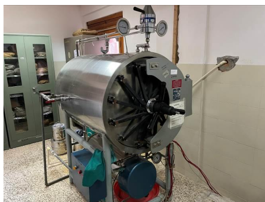
写真 8 : タシガン県病院/高圧蒸気滅菌器
