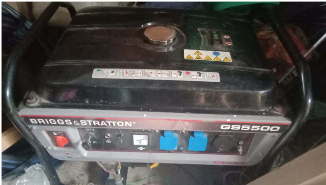
既存小型ポータブル非常用発電機（5500W 定格仕様）
