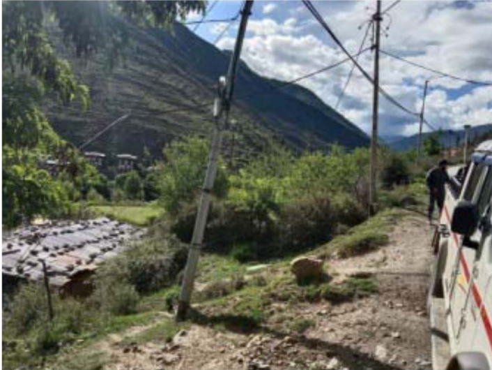
架空線による電力供給
