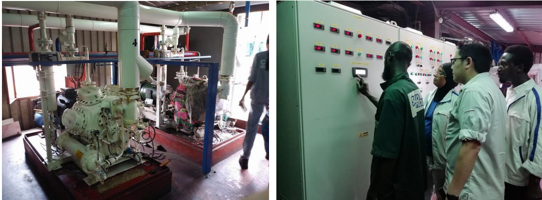
タイミングが良く、圧縮機が1台メンテナンス中であった
