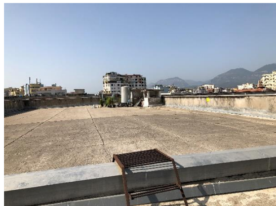
写真-16: 屋上 空調室外機は屋上に設置される
