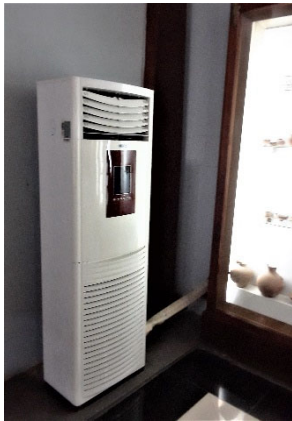
【写真 7 博物館の空調】 館内には空調機が多数 設置されているが、除湿 機能は十分ではない。
