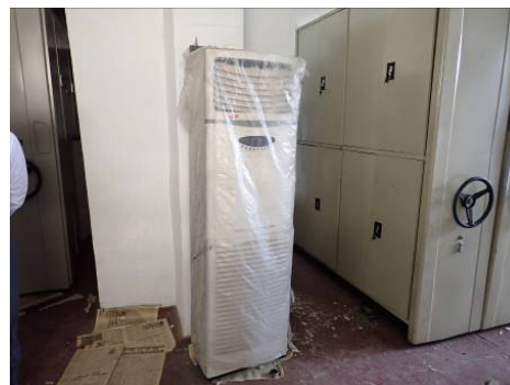
写真 14 既存の空調機材。5台のうち1台のみが稼働(老朽化により故障頻発)しており、その1台もフロア全体をカバーできる仕様とはなっていない。
