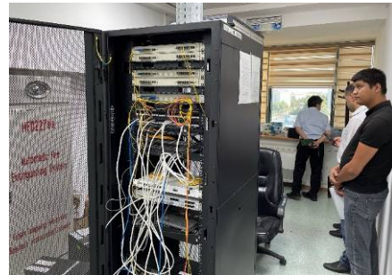
写真-2：CHA10 階サーバー室。文化省内の既存サーバーを当該ラックに移動予定
