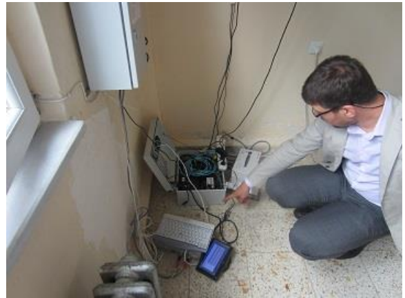
9/ 8 水道局の Tekirdag 事務所に設置された強震計（活動 3-1）
