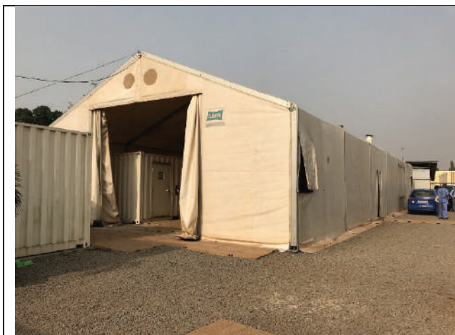
INSP ノンゴ分室 大テント外観 開口は大きく開けられ、外気と分断されていない。
