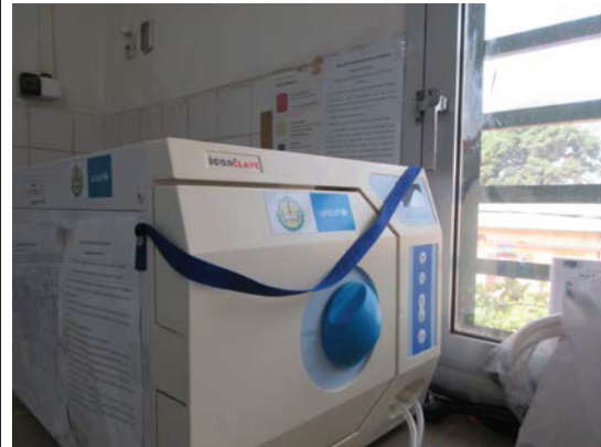
既存 INSP 細菌学ユニット オートクレーブ： 小さいオートクレーブのため、作業効率を向上させ るためにはさらに大型のものが 必要。 (2020年1月21日撮影)
