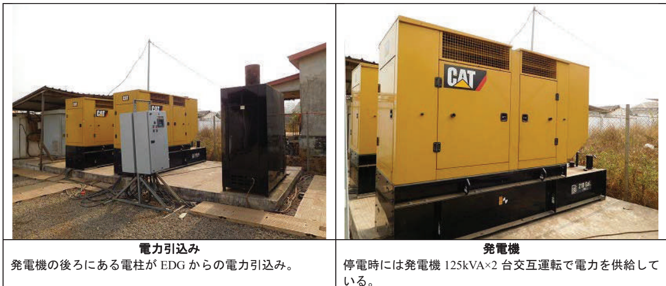
図 2-1-9 INSP ノンゴ分室電気設備
