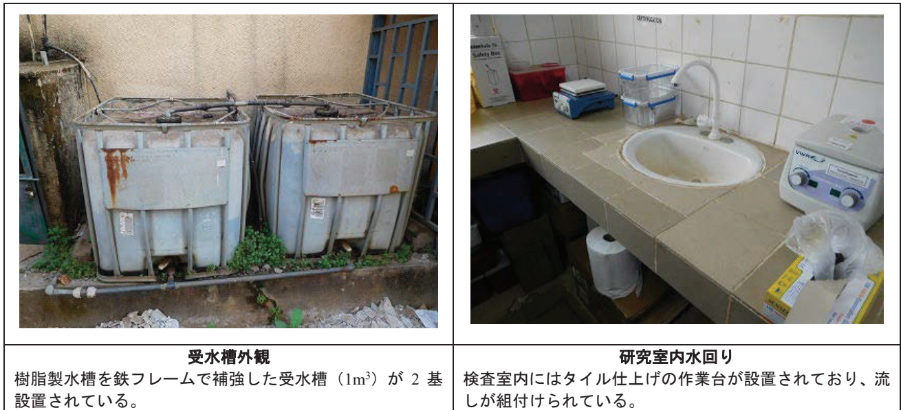
図 2-1-5 既存 INSP 給排水衛生設備
