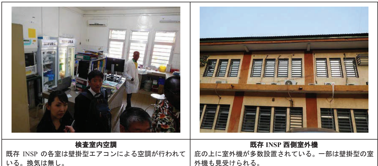
図 2-1-6 既存 INSP 空調換気設備
