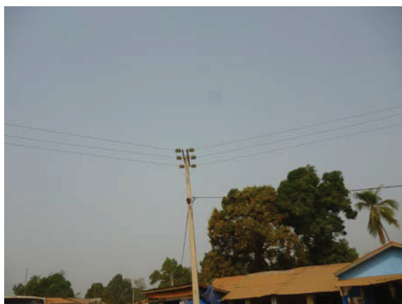
本プロジェクト建設予定地周辺の電線の様子 ギニア電力公社 (EDG) により整備されている建設予定地から 200m の位置にある 20kV 配電線。ここより建設予定地まで EDG による配電線延伸が必要。(2020年1月25日撮影)
