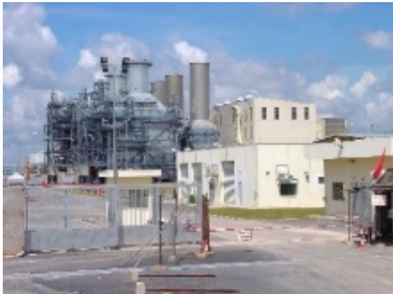
図 3.5-3 フーミー I 発電所
