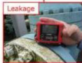
Check valve flange (15%LEL)
