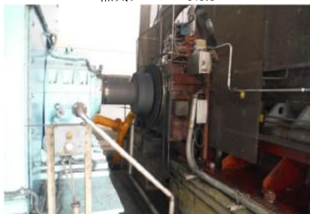
蒸気タービン No.3
