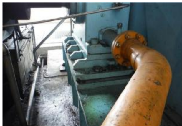
蒸気タービン No.5
