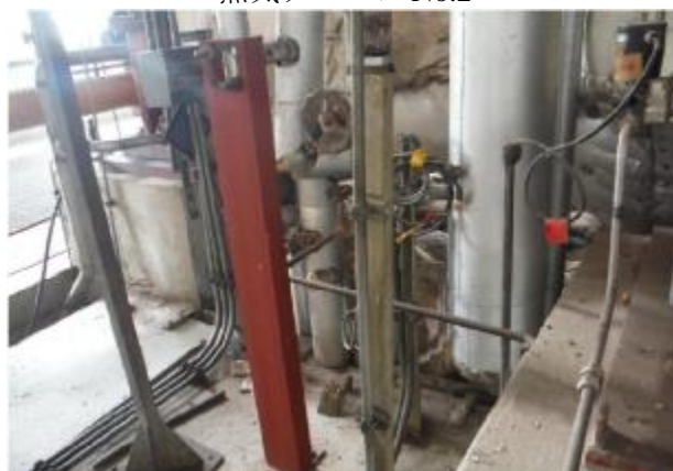
蒸気タービン No.4
