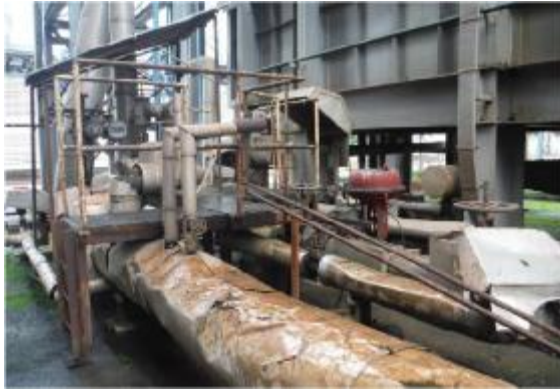
HRSG 共通不具合 No.7
