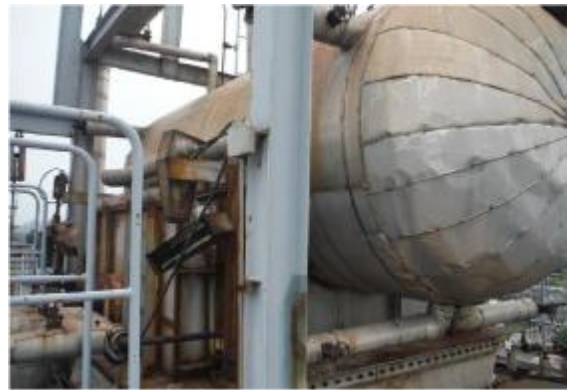
HRSG 共通不具合 No.6
