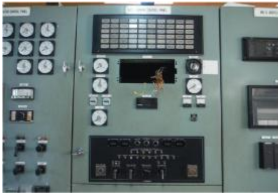
制御・操作盤
