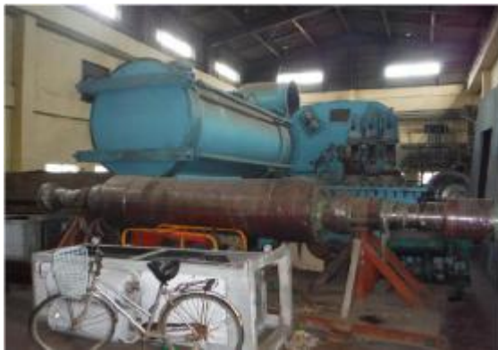
蒸気タービン No.1
