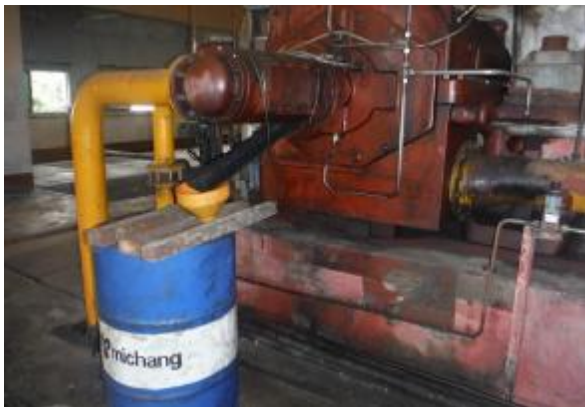
蒸気タービン No.1
