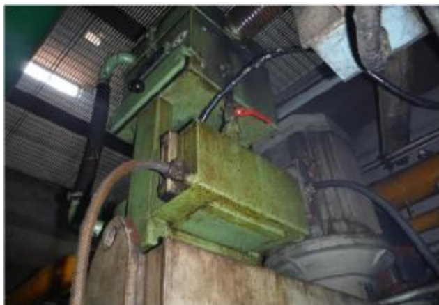
蒸気タービン No.1
