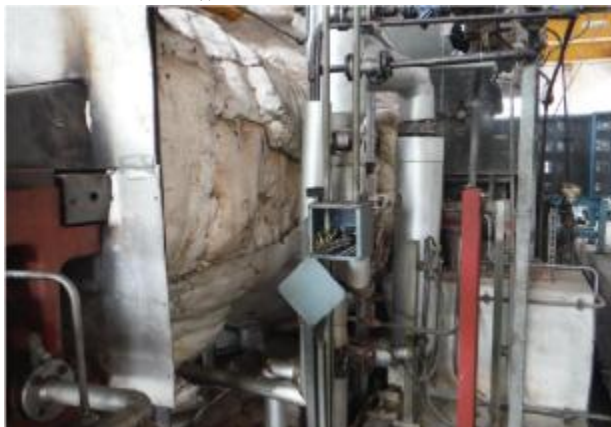
蒸気タービン No.6
