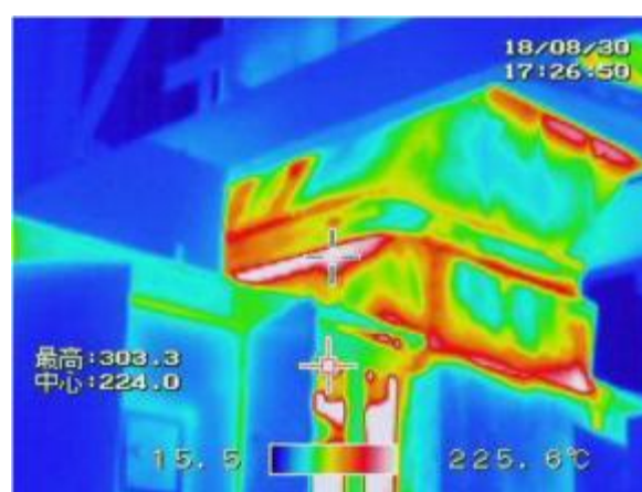
F5-#2GT 排気ダクト温度上昇
