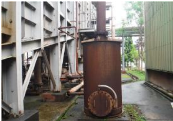
HRSG 共通不具合 No.5
