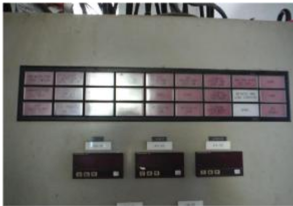
損傷した常設計器
