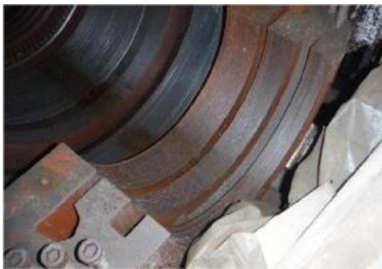
蒸気タービン No.3
