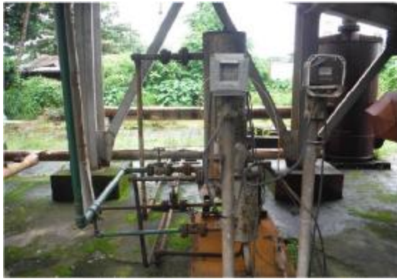
HRSG 共通不具合 No.1
