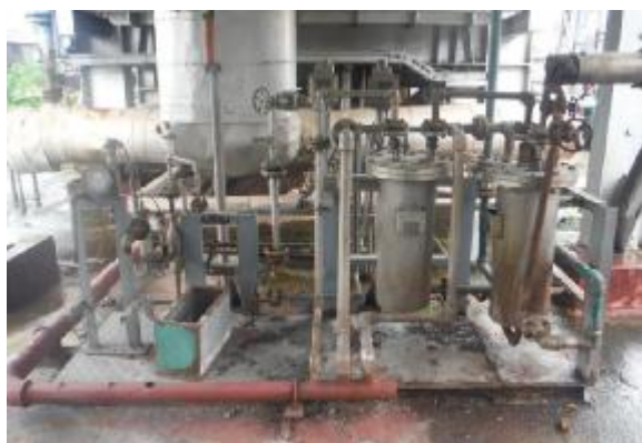
故障した常設計器
