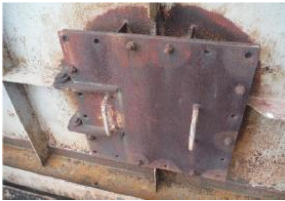
HRSG 共通不具合 No.3
