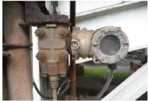
HRSG 共通不具合 No.2
