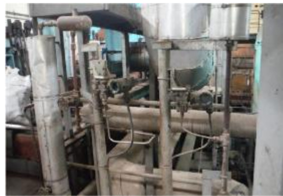
蒸気タービン No.4
