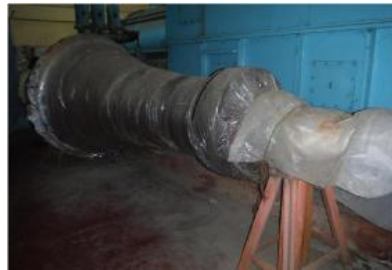
蒸気タービン No.2
