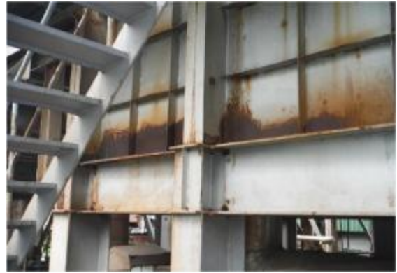
HRSG 共通不具合 No.8
