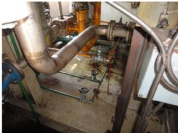
蒸気タービン No.2
