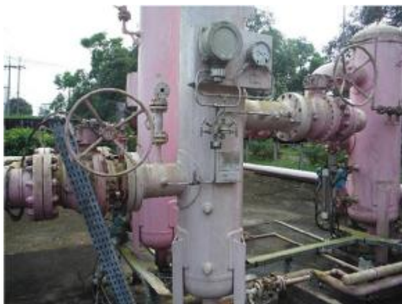
ストレーナ出入口フランジよりガス漏れ
