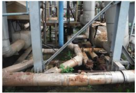
HRSG 共通不具合 No.4
