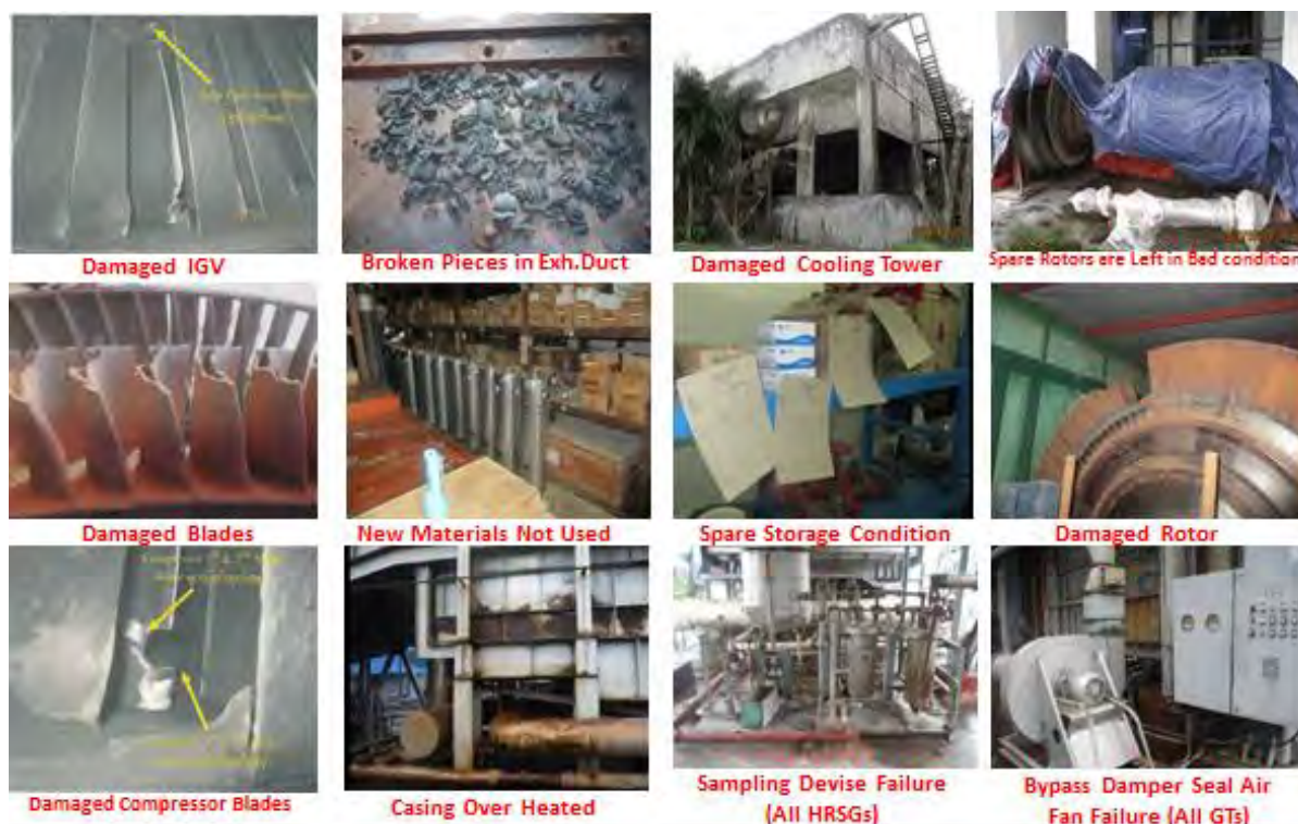
図 3-26 各種損傷状況(2018.8)
