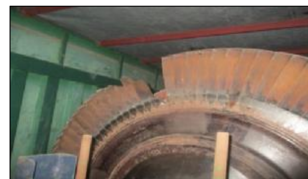
損傷状態で放置中のガスタービンローター
