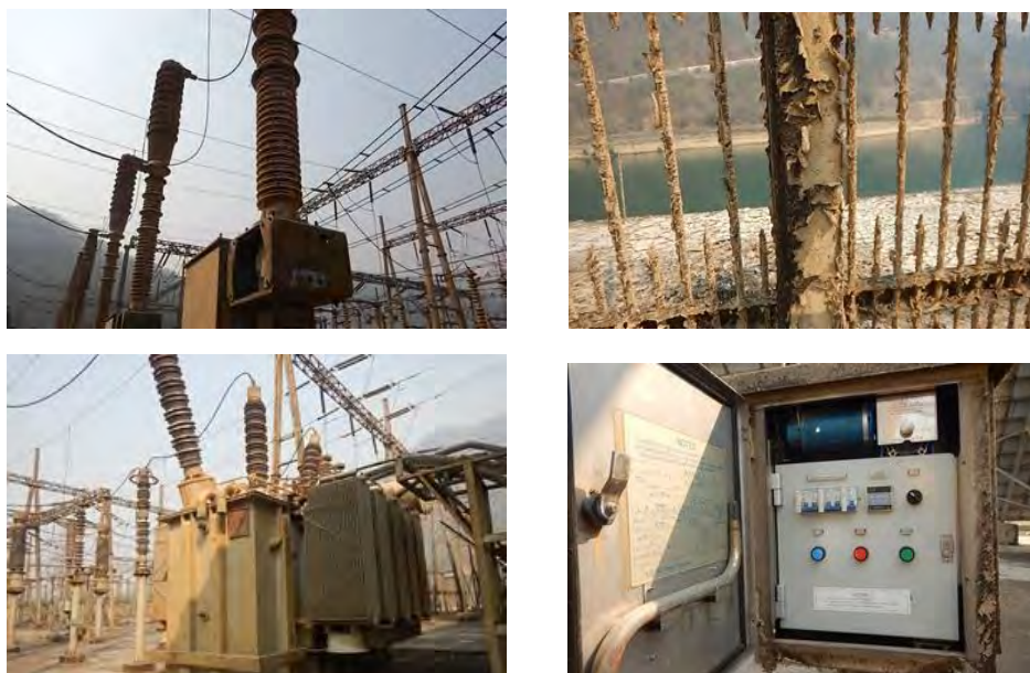
図 3-34 開閉所汚損状況写真
