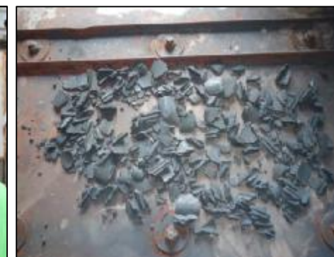
ガスタービン内から発見された損傷部品
