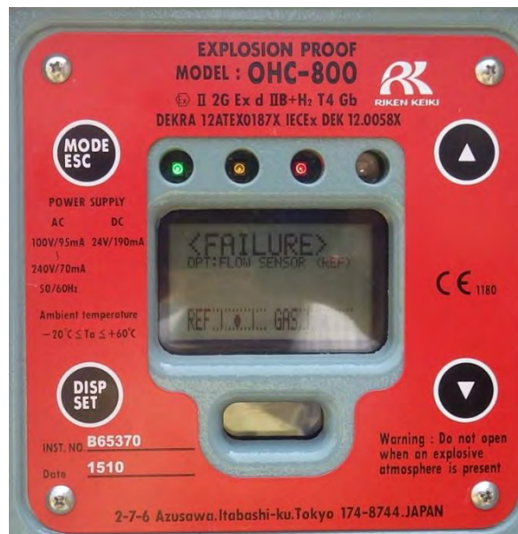
図 4-8 発熱量計表面液晶表示“FAILURE”の表示あり
