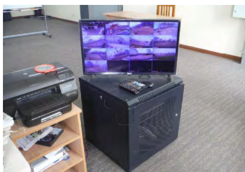
図 3-21 セキュリティカメラ監視画面 (ティラワ発電所)
