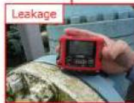
Check valve flange (15%LEL)
