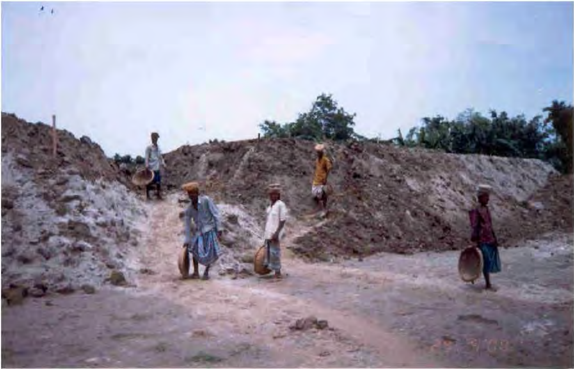
চিত্র-৬ এভাবে বাঁধ নির্মাণ করা যাবে না। মাটি ১৫ সেমি স্তরে স্তরে ফেলে কমপ্যাকশন করতে হবে।
