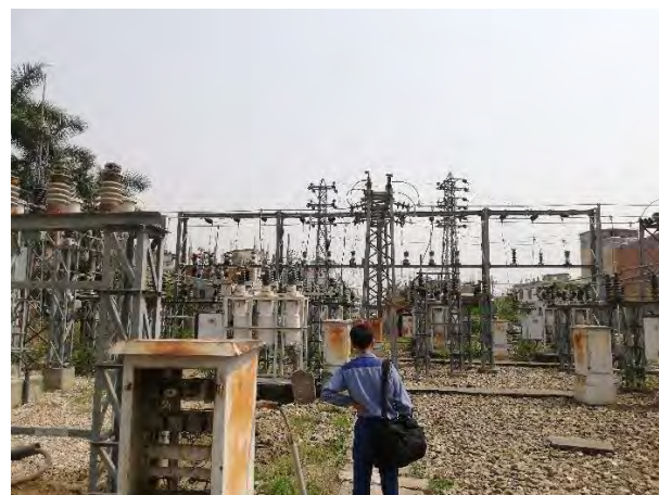
図 4.2-37 New Nepalgunj 変電所
