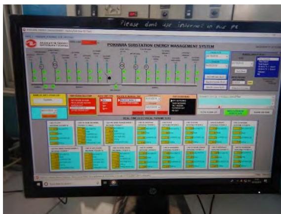
図 4.2-3 11kV 配電システムの監視モニター
