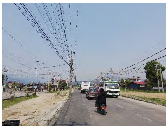
図 4.2-11 変電所西側の配電線施設状況
