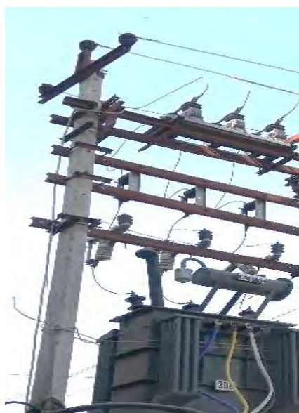
図 2.2-7 配電用変圧器の設置状況
