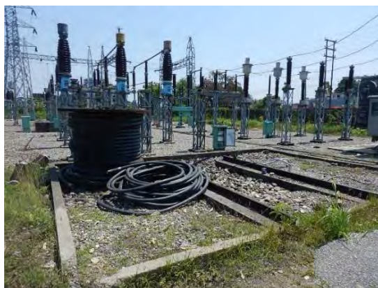
図 4.2-4 変電所増設用のスペース
