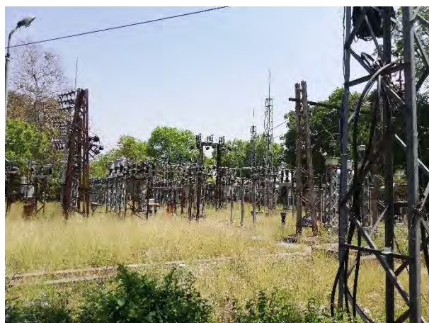
図 4.2-36 Old Nepalgunj 変電所
