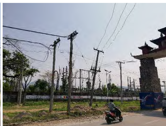
図 4.2-12 変電所からの引出状況
