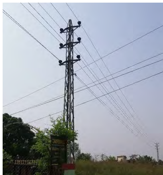
図 2.2-8 33kV 鉄塔方式送電線
