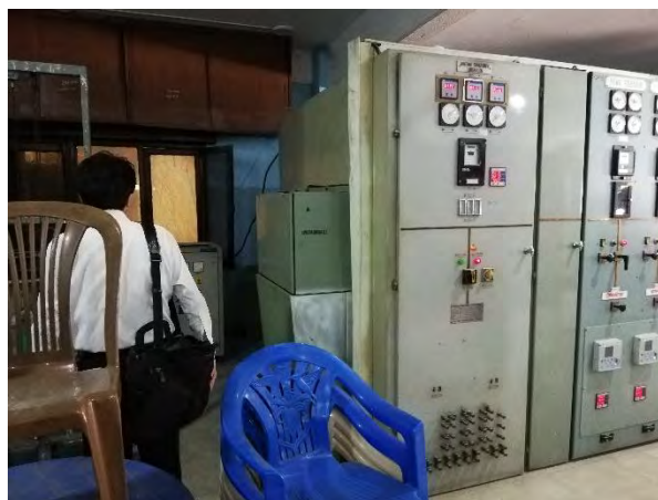
図 4.3-11 フィーダー盤増設スペース
