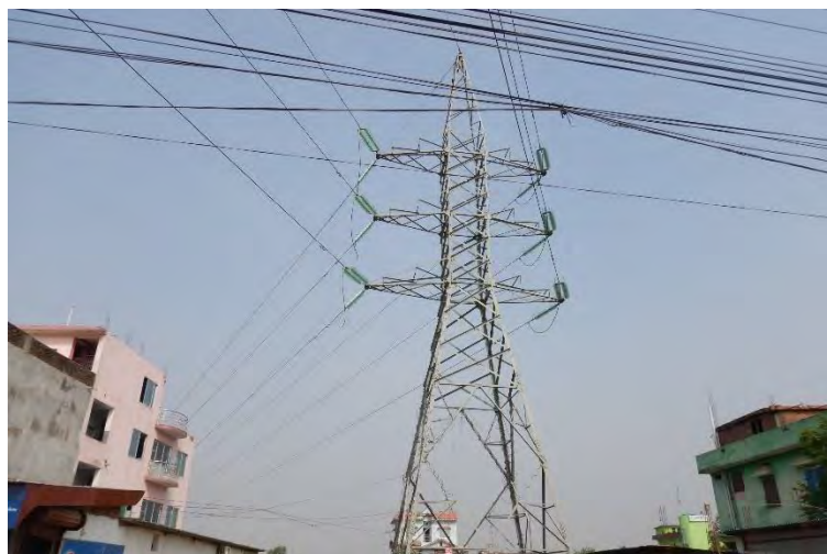
図 4.2-24 Kohalpur—Bhurigaon の既設送電線の鉄塔
