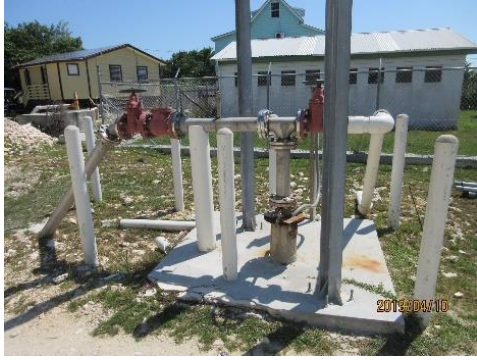
取水井（ビーチウエル）
