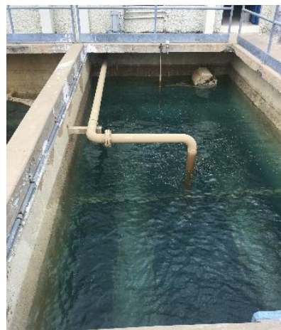
急速ろ過池（洗浄工程②：静置）
