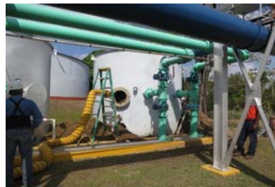
急速砂ろ過装置(ろ過砂交換作業中)
