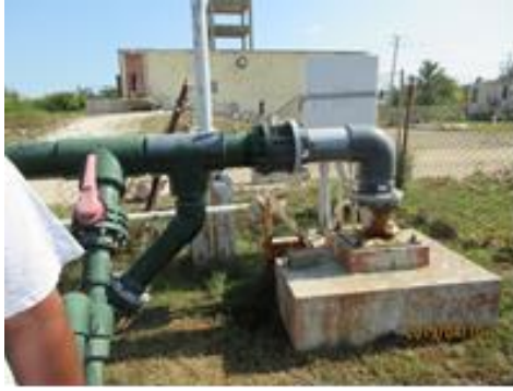
取水井(ビーチウェル)
