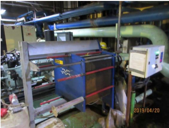
蒸発方式淡水化機器 (アルファラバル社製)
