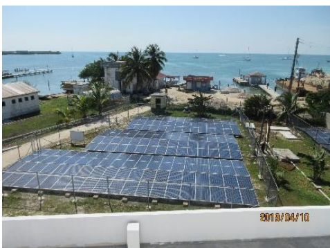
敷地内の太陽光発電装置
