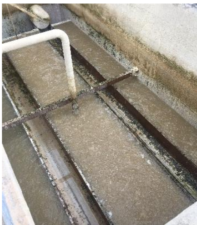
急速ろ過池（洗浄工程①：逆洗浄）
