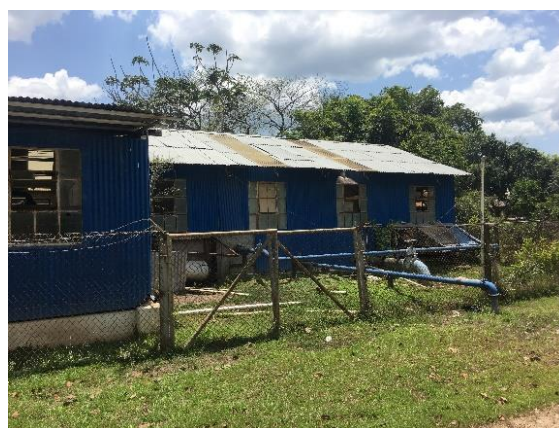
導水パイプ（手前の水色の管）
