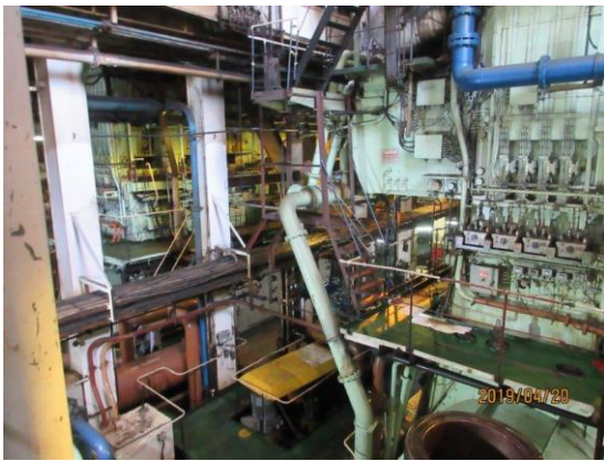
発電機 (20MW x 2 基)
