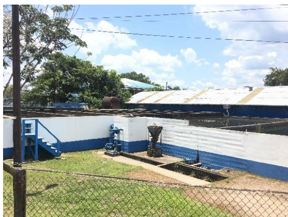
凝集沈殿地（左奥→右手前の工程）
