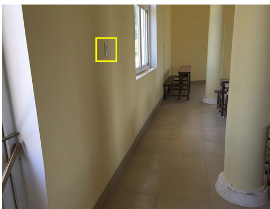
CCCO 支援の避難施設の2階の様子（電源は洪水に備え壁上部に設置され、電気の使用が可能）
