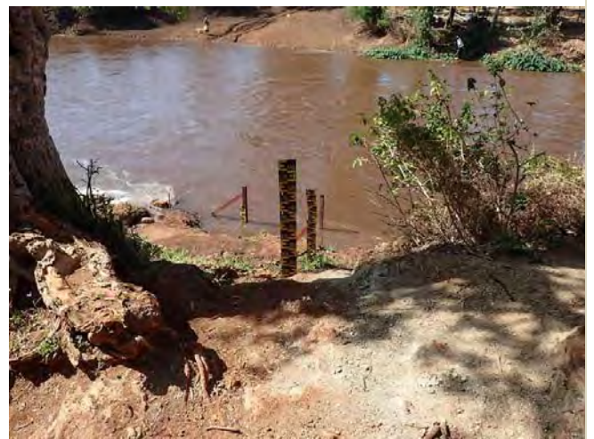
修繕前の水位標（4DD02、2017/10/12）
