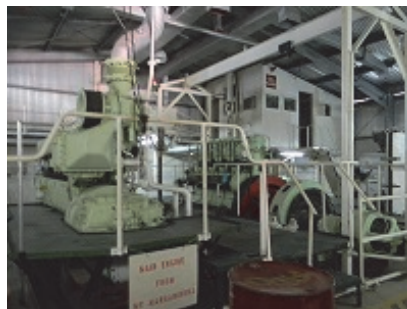
エンジンプラント実習施設
