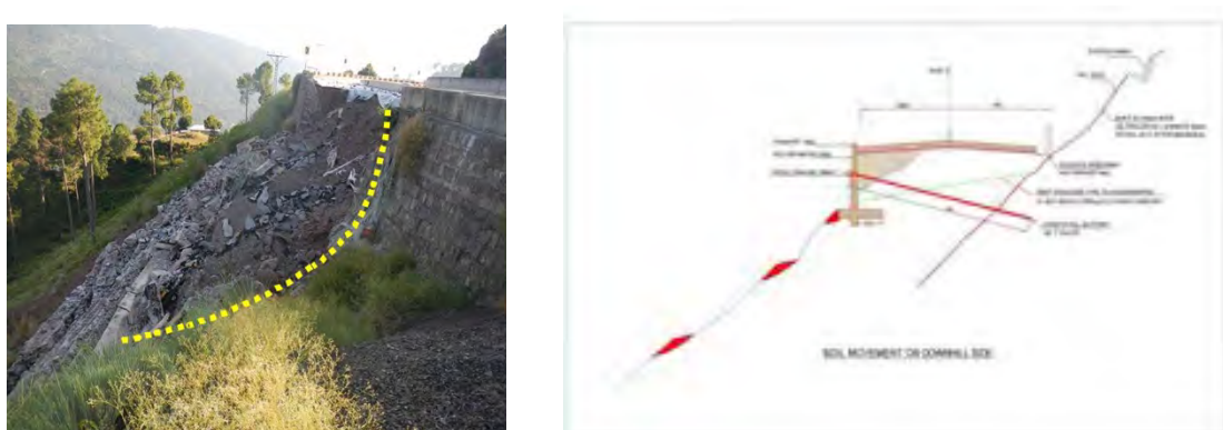
図 2.9 2015 年 9 月 N-75 で発生した土砂災害と対策工
