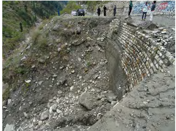
写真10 土石流発生箇所(N-15)
