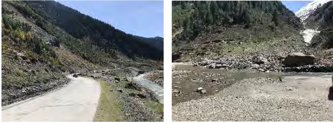
図 4.44 コンクリート舗装の一例(N15_8 斜面)と、冬季の雪氷の影響を緩和するため舗装を伏せ越しさせた箇所(N15_10 斜面)(出典:調査団)
