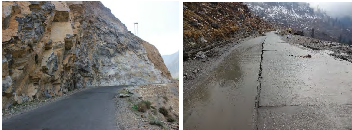
図 4.41 不適切な切土勾配(左)及び盛土基礎の支持不足(右)
