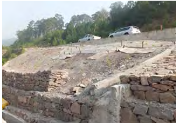
図 4.42 N-75 における道路谷側の石積(出典:調査団)
