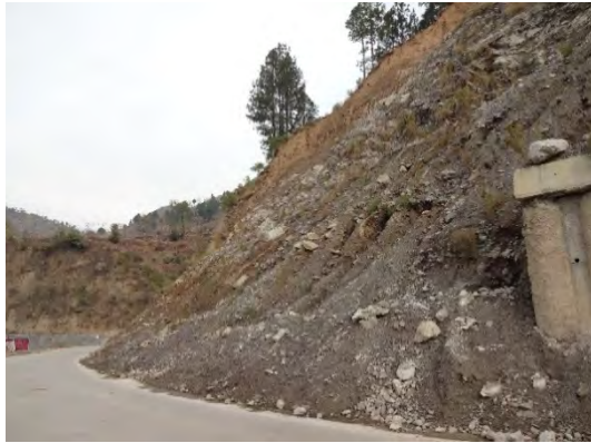
N35_1で発生する表層崩壊
