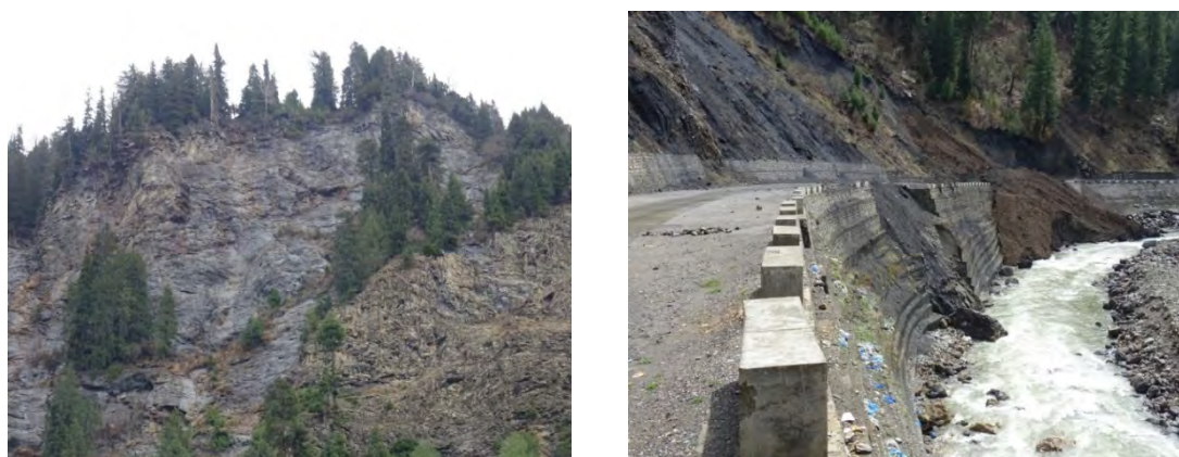
図 4.36 岩壁面(N15_8)基盤浸食により既存擁壁が崩落した様子(N15_9)(出典:調査団)
