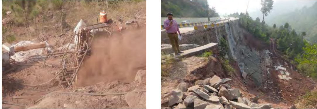
図 4.45 マイクロパイル(斜坑)を打設するために穴を掘っている状況(左)と、道路谷側の盛土崩壊状況(右)(N-75)(出典:調査団、2017年11月撮影)
