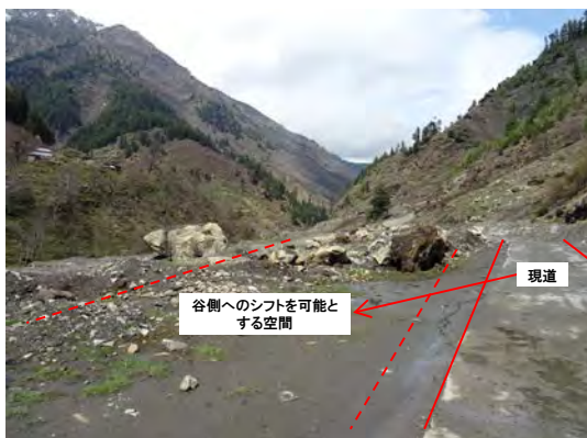
図 4.66 現道部分の平坦面が幅広であるため谷側へシフト可能な箇所の例(N15_8) ※シフト可能でも災害回避できるとは限らない (出典:調査団)
