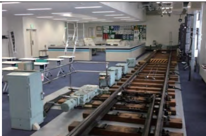
架線・信号・軌道等の設備
