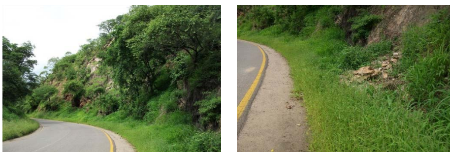
写真 5.1-7 切土法面の片麻岩の露頭と落石（右岸側取付道路部）
