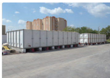
消防署内の貯水タンク
