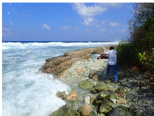
(P1 既設のセメントバッグの護岸(一部崩壊))
