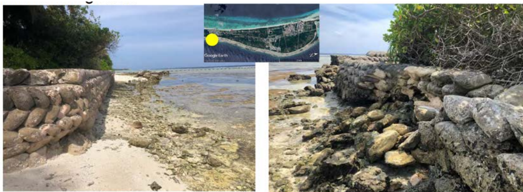
(Heritage site 前の海岸の様子とセメントバッグによる護岸の崩壊)
